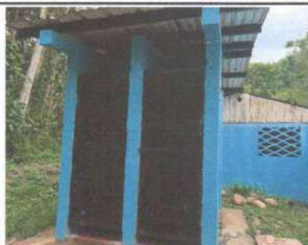
Foto 4: Se observa la sustitución de puertas efectuada
